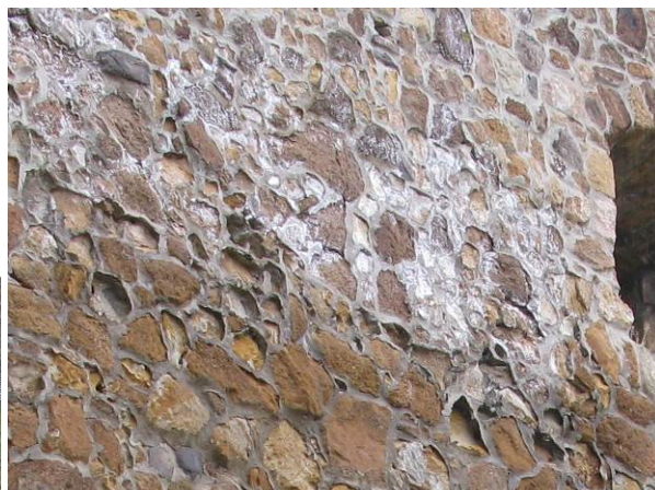
foto 16 Degradácia kameňa, zasolenie
