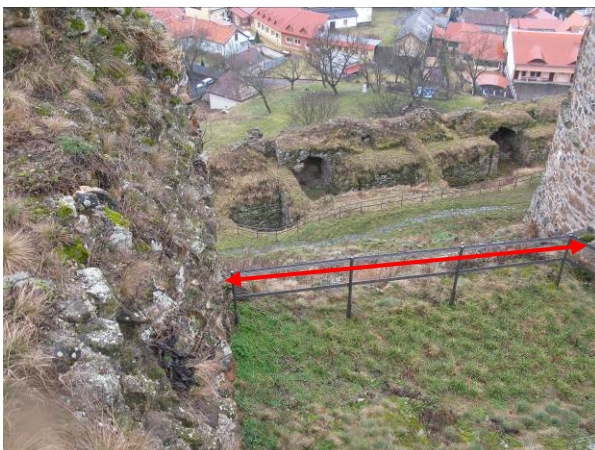
foto 34 Deštruovaná časť vých.časti južnej steny
