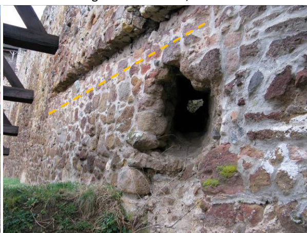
foto 18 Degradácia kameňa, zasolenie
