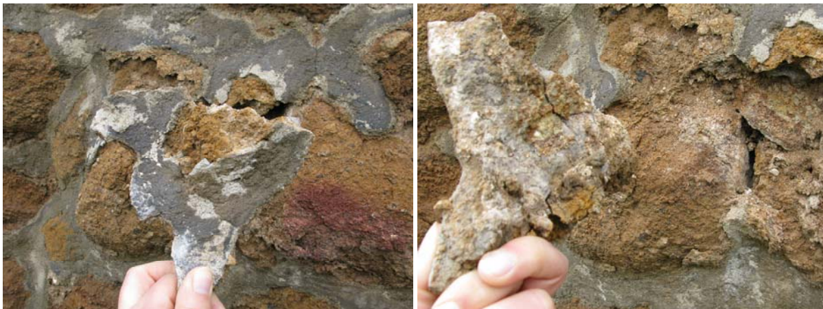
foto 49, 50 Detail deštrukcie v mieste škárovania cementovou maltou
